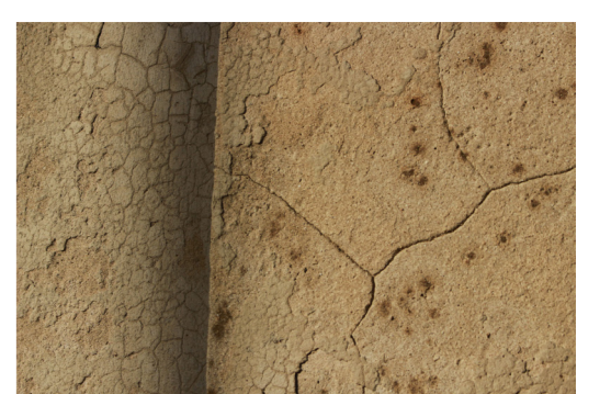
Faïençage sur la façade sud
