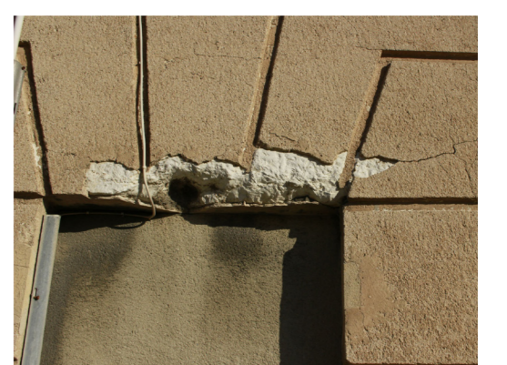
Emergence de pierre de Fontvieille sous l'enduit du cadre d'une baie
