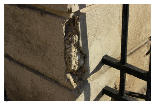
Emergence de Poudingue sous l'enduit
